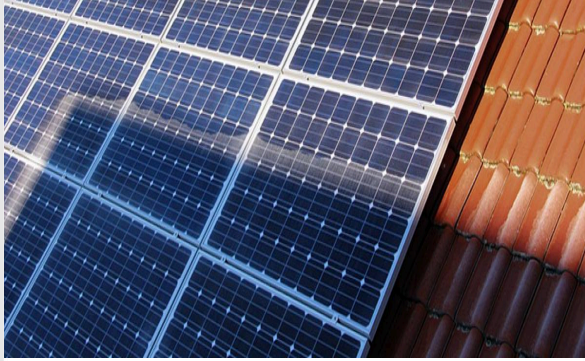
Ein Schatten über einer Solaranlage
